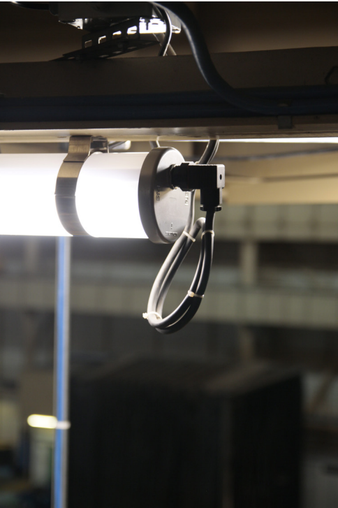
Centrale de Paluel Installation d'un Tukore avec connecteur Hirschmann
