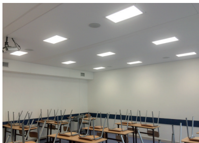
Salle de classe réhabilitée avec des luminaires SFEL.
